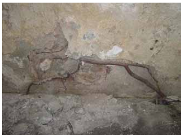
Keller Wände Wurzeldurchbruch
