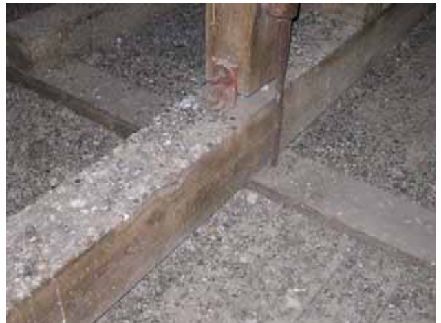
Verschmutzung durch Taubenkot
