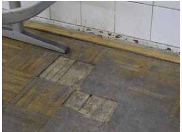
Parkettbelag Raum 1.05 / 1.OG
