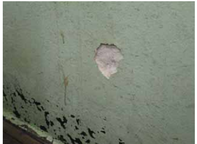
Wandschäden Raum 0.03 / EG
