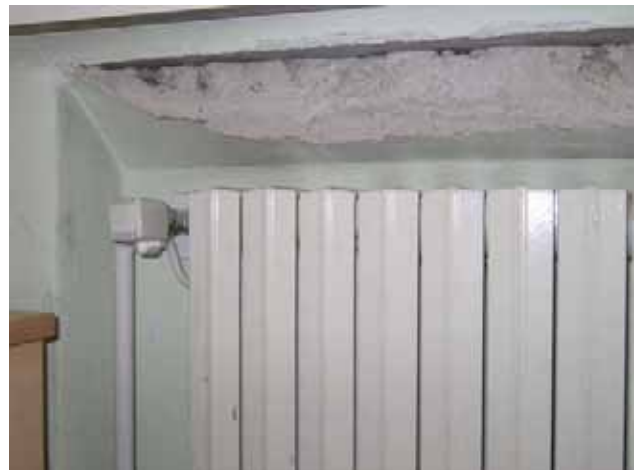
Putzschäden Raum 3.02 / 3.OG
